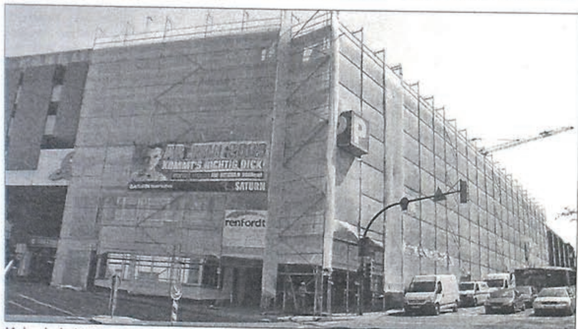
Mehr als drei Millionen Euro investiert die Gesellschaft für Wirtschaftsförderung in den Umbau des Gebäudekomplexes am Kurt-Schumacher-Ring. Foto: Wronski
