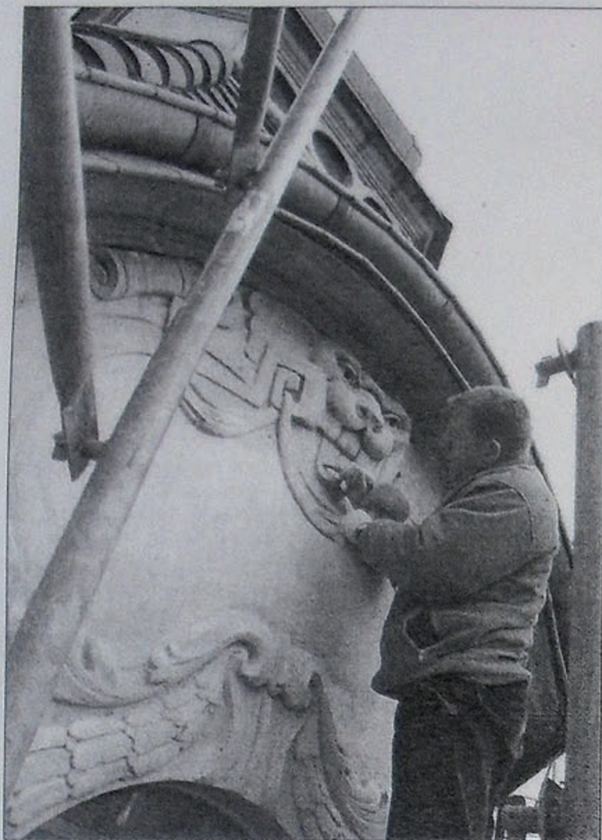
Voller Akribie und mit viel Liebe zum Detail werden zurzeit die Ornamente der Fassade restauriert. Foto: Wronski
